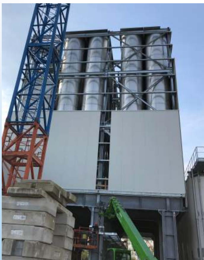
Sili lisci bullonati INOX, in batteria, su struttura metallica.
