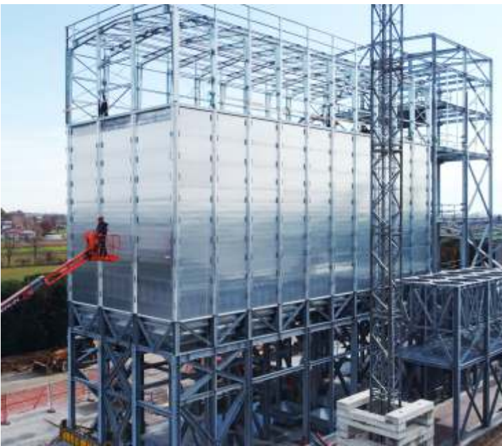
Batteria di celle a pareti piane sandwich con edificio industriale metallico.
