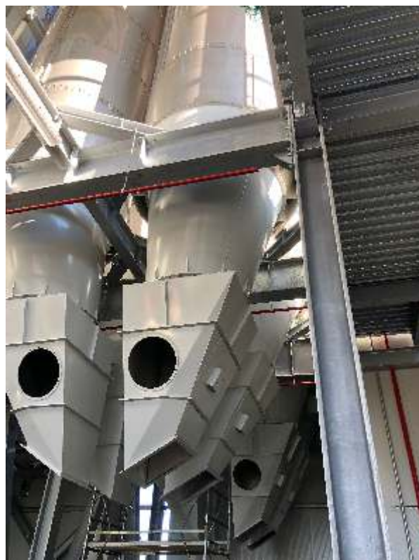
sili lisci bullonati con tramoggia asimmetrica, per carico rapido alla rinfusa.
